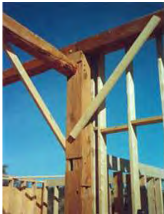
La pared exterior de trama de madera del nivel superior lleva los revestimientos y aberturas como una pared de cortina. La misma, se asegura a la estructura superior de madera sobre el nivel de esta .
