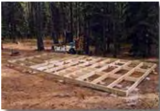
La plataforma flotante de 27 m2 y su bastidor perimetral de madera tratada a presión.
