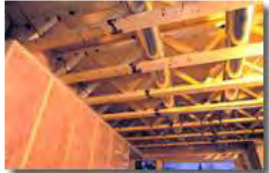
Vigas abiertas, tipo Joist 2000, conforman las cabreadas se usaron para la construcción del techo y el piso. En las cabreadas se tendieron los conductos.
