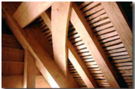
Maderamen de la cubierta y su refuerzo diagonal para la estabilidad lateral.
