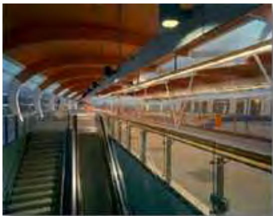
Vista general del interior del andén donde se perciben los distintos materiales en sus funciones específicas.
